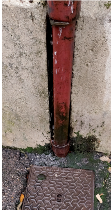
traces de coulures verdâtres derrière le dauphin
