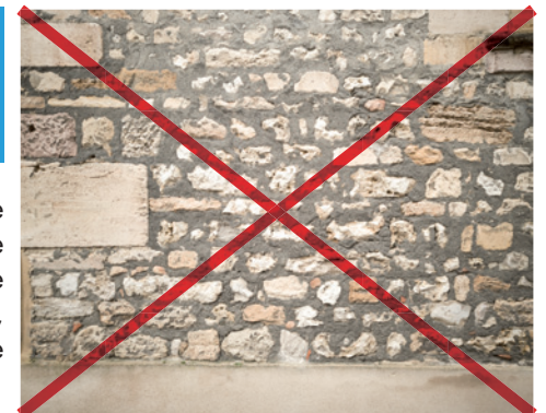
joints en ciment
